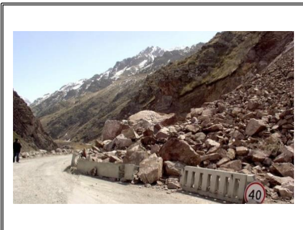
キルギスでの落石被害状況
