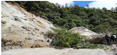
ブータン国の 落石被害状況
