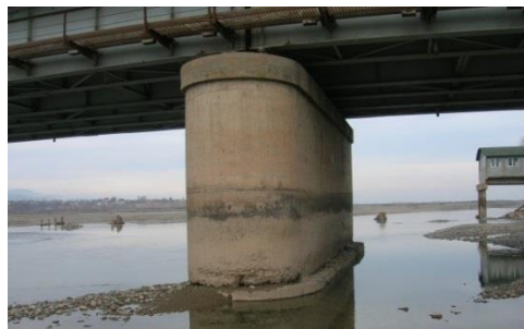
コンクリートの剥離がみられる現地の橋脚
