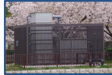
水質浄化装置 BFシステム外観
